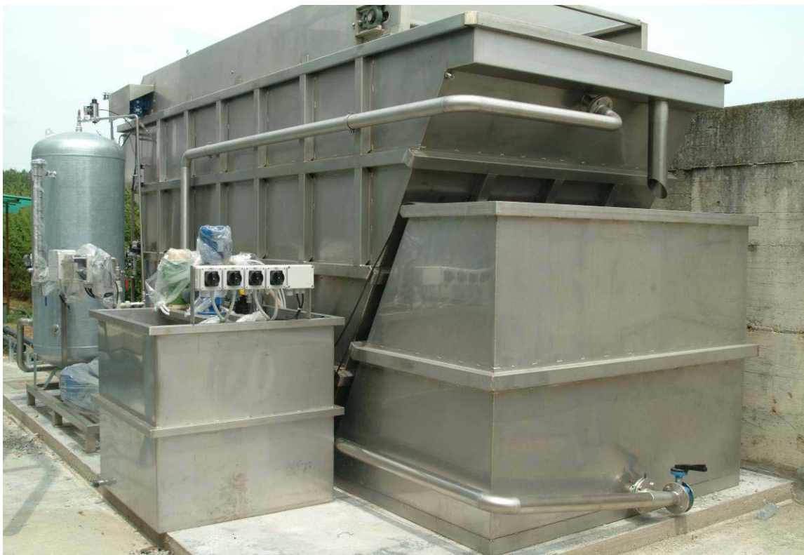
Complessivo dell'impianto di flottazione per il trattamento delle acque reflue
