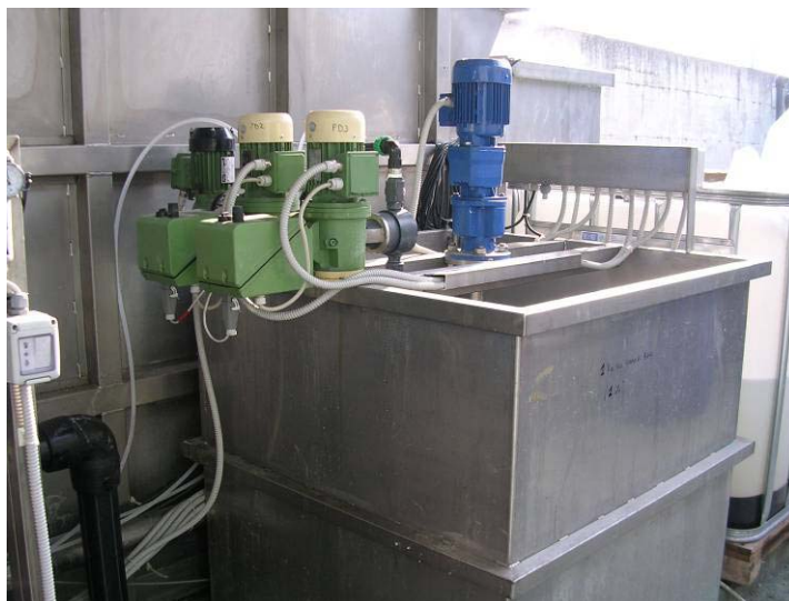
Vasca per il polielettrolita e pompe per il dosaggio dei prodotti.
